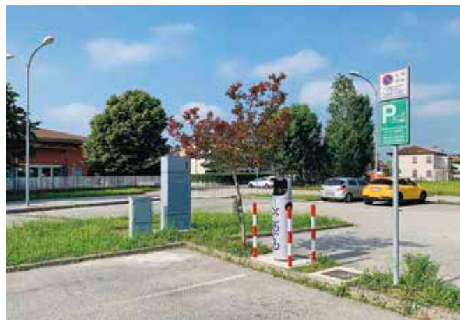
Colonnina di ricarica elettrica via Dante
